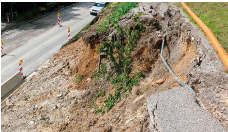
Rutschung an einer Straße
