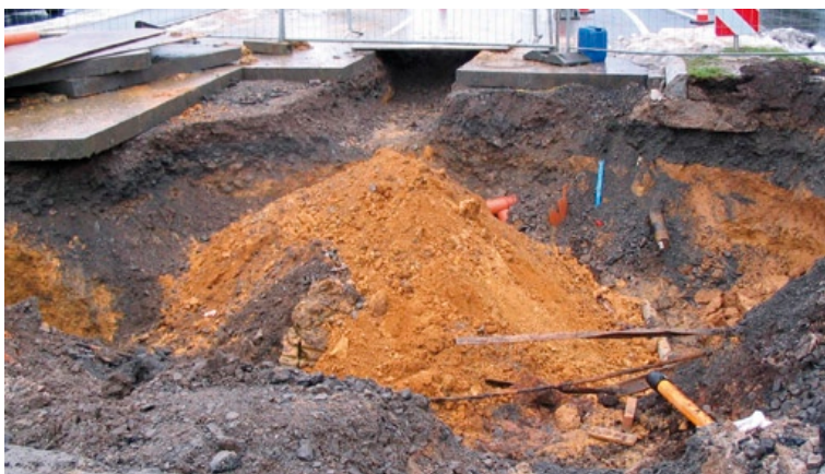
Erdfall in einer Straße im Stadtgebiet
