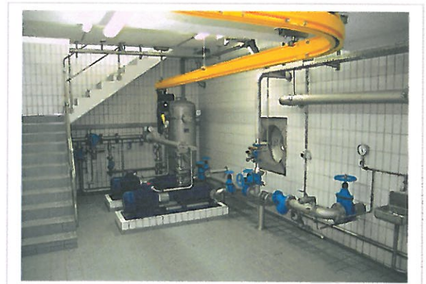
Das Bild zeigt ein Pumpwerk in Josefstal, eines von über 18 Anlageteilen in der Wasserversorgung in Schliersee.
